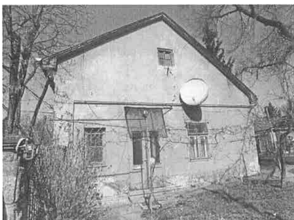
épület külső (DK-i homlokzat repedése)
